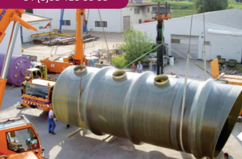
GVK koelwaterleiding RWE centrale Eemshaven (NL)
